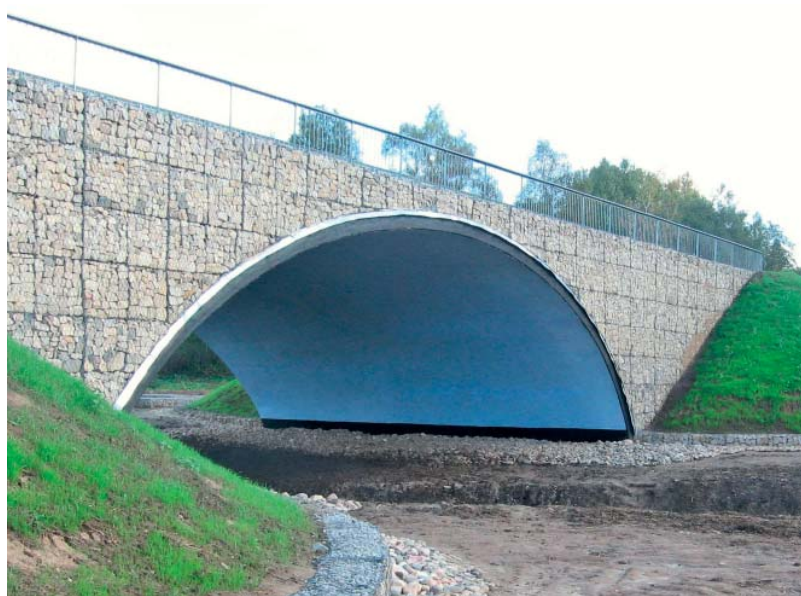
Общий вид после капитального ремонта моста через реку Тоймина км 299+185 автомобильной дороги М-8 «Холмогоры»
