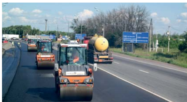
Укладка верхнего слоя покрытия из щебеночно-мастичной а/б смеси ЩМА 19 на участке автомобильной дороги М-5 «Урал» км 81+000 – 87+000
